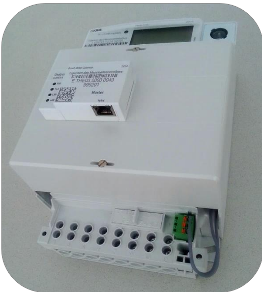
Abbildung 37: Zähler mit montiertem SMGW und Modulabdeckung. Richtige Lage und Länge der Stromkabel.
